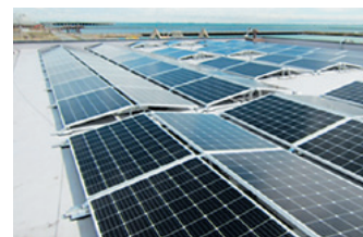
▲太陽光発電設備
